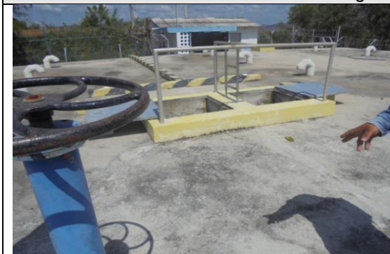
Descripción Registro Fotográfico: Válvula Sobre la Cubierta de Tanque
