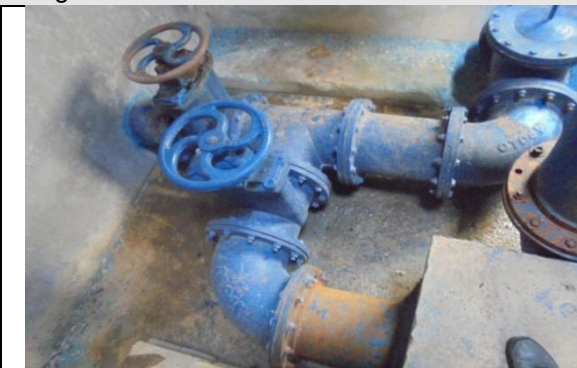
Descripción Registro Fotográfico: Válvula Red y Desagüe - Izquierdo
