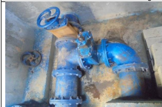
Descripción Registro Fotográfico: Válvula Red y Desagüe – Derecho
