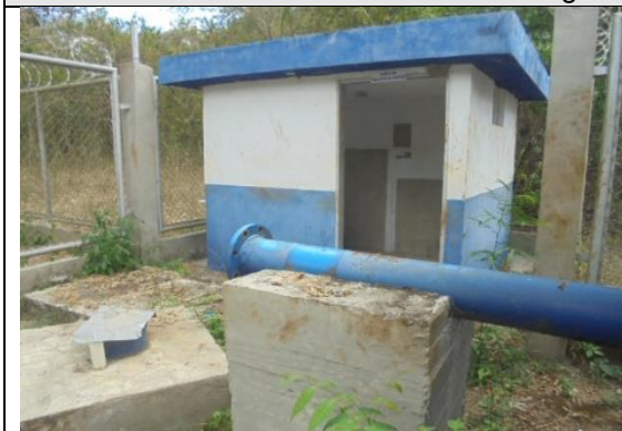
Descripción Registro Fotográfico: Pozo y Caseta de Tablero de Control
